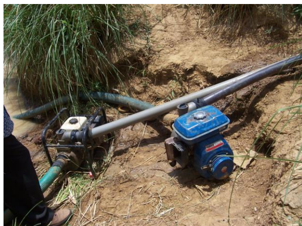
Photo 5: Motopompes exposées au soleil
