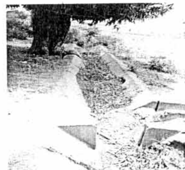
Photo 2 : canal tertiaire ensablé
