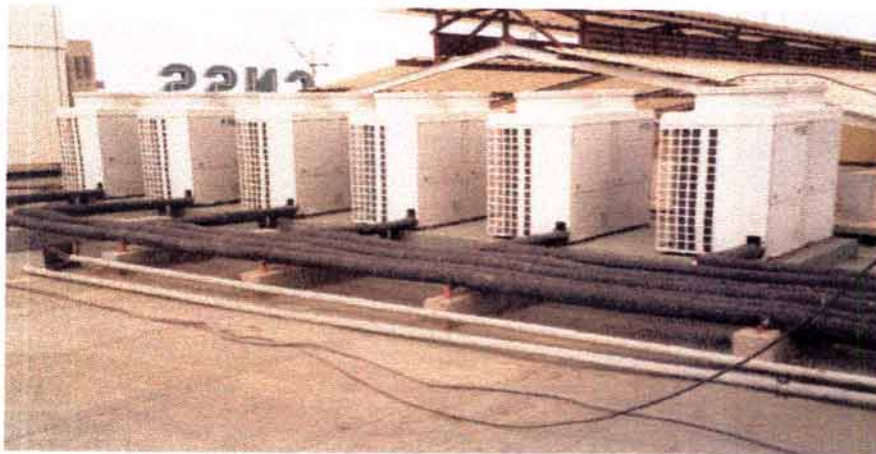
Photo N°4 : Des batteries de VRV (unités extérieures)
