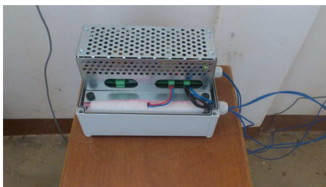
Figure 20: Alimentation stabilisée 24 Vcc.
