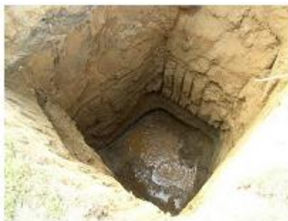
Figure 6 : Exemple de puits perdu dans le centre de Tnine des Oudaya
