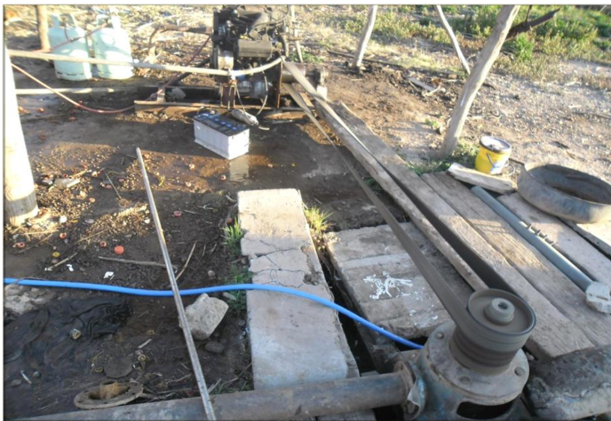
Figure 7: fonctionnement des pompes
