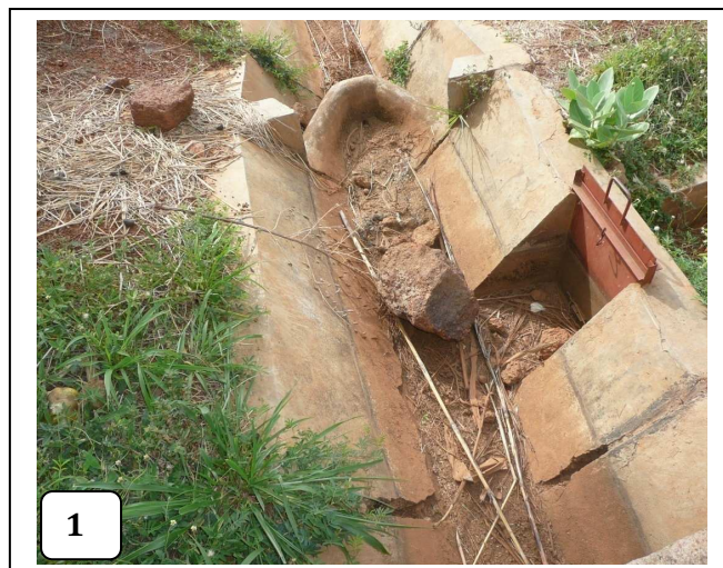
Photo1 : Etat du canal primaire au niveau du CS 2 : avec joints bitumeux détériorés
