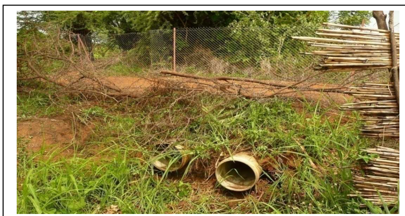
Photo 8: les PVC de petit diamètre implantés sur le drain principal
