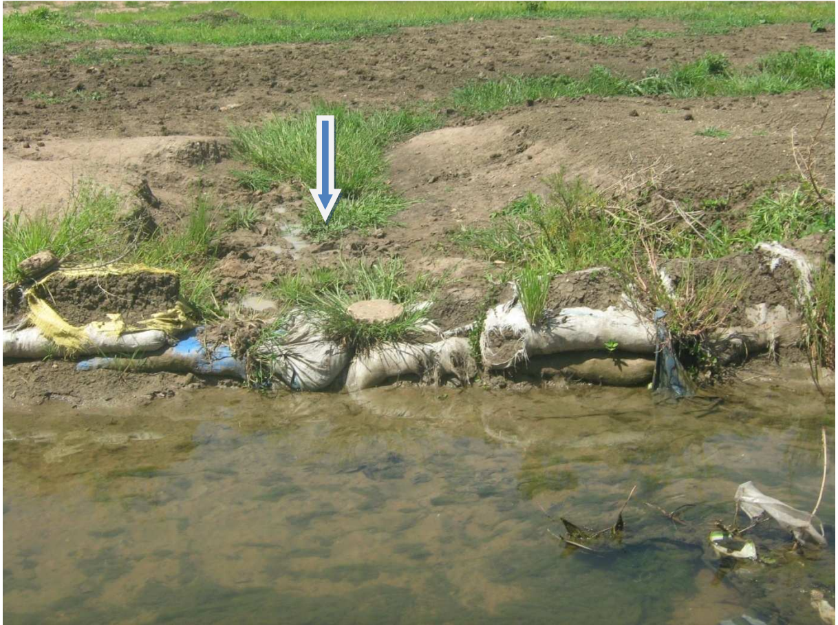
Photo 2 : Erosion des berges du canal tête morte
