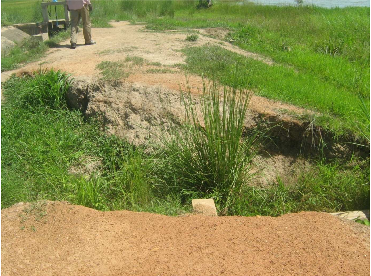
Photo 5 : Erosion de piste secondaire (Bloc E, Bessoum)
