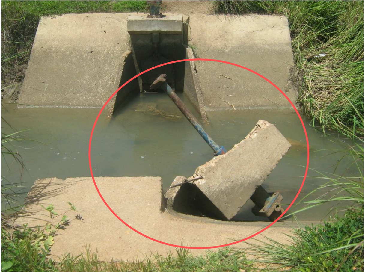
Photo 4 : Vanne du canal tertiaire endommagée
