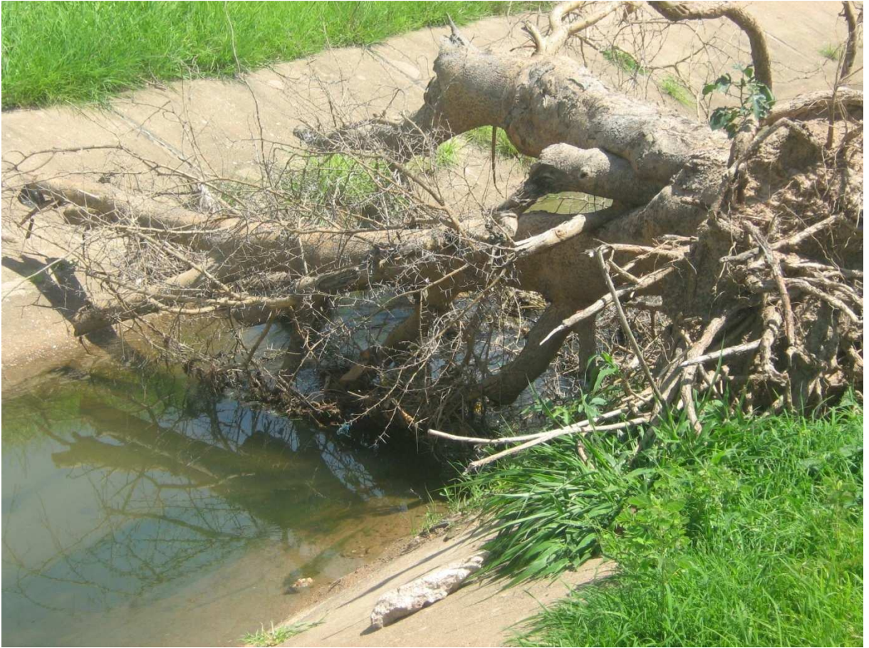
Photo 1 : Tronc d'arbre obstruant le canal principal
