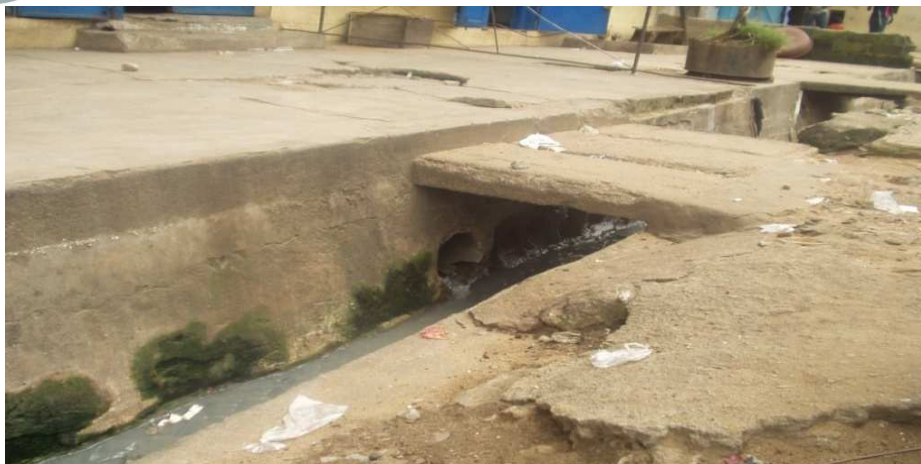
Figure8 : Evacuation des eaux usées domestiques via les raccordements illicites
