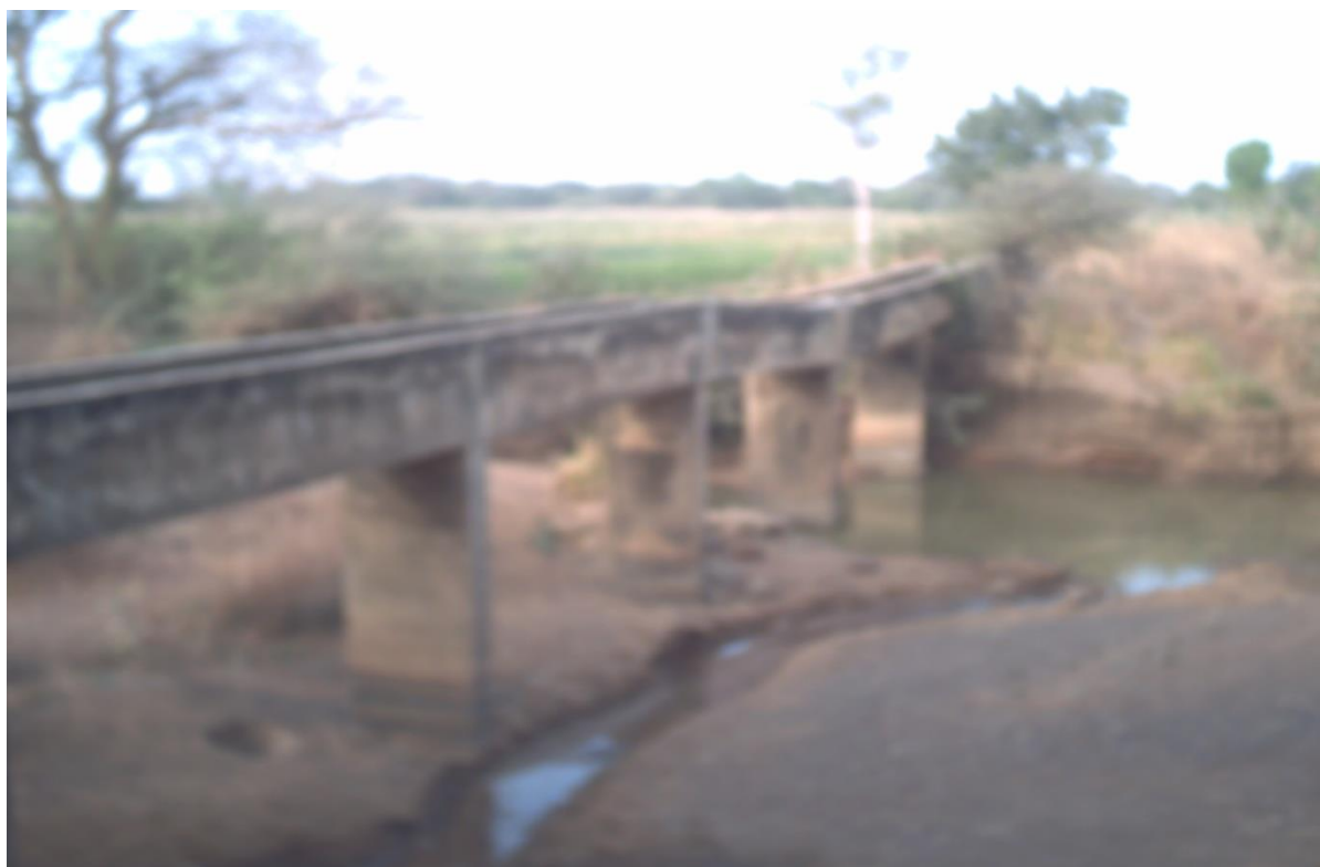
Photo 4: Impact de l'érosion sur un ouvrage
