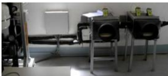
Photographie 6: Les deux ventilo-convecteurs du bâtiment climatisation solaire
