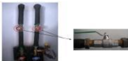
Photographie 18: Image des robinets-vannes de l'installation et celle d'un robinet tournant
