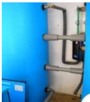
Photographie 3: Raccords entre les ballons de stockage d'eau chaude
