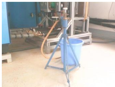
Photographie 14 : Image de la purge manuelle
