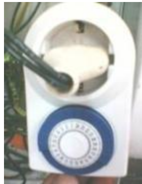
Photographie 19: Image de l'interrupteur horaire de l'installation
