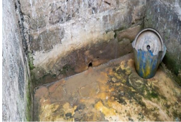
Figure 8 : Photos montrant l'état des douches rencontrées
