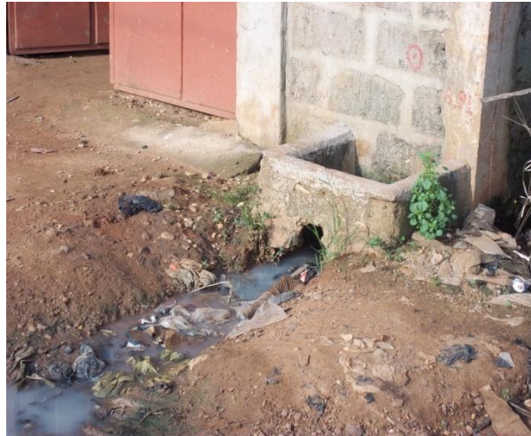
Figure 10 : Photos montrant le mode d'évacuation des eaux provenant des douches
