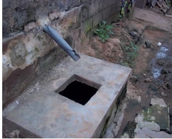
Figure 6: Toilette et Douche connectées à un puisard
