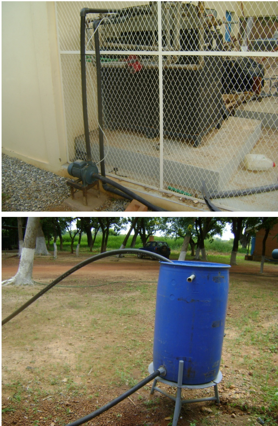
Figure 21: vue du montage du système de refroidissement
