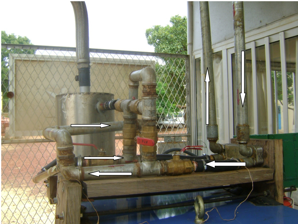
Figure 16: vue général du montage du système de récupération de chaleur du groupe
