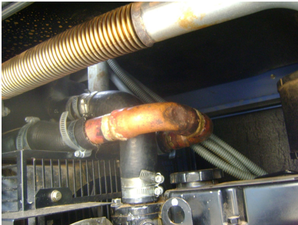
Figure 15: vue du raccordement sortie pompe et entrée radiateur
