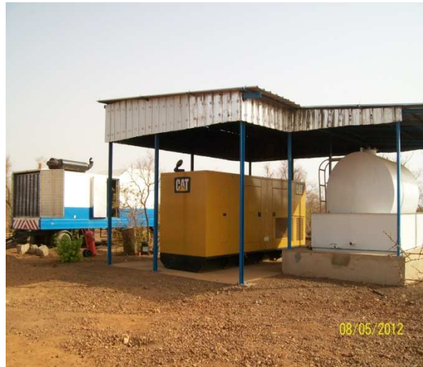
Photo 5 : centrale électrique à Bissa Gold
