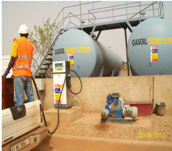
Photo 4 : station de stockage de carburant
