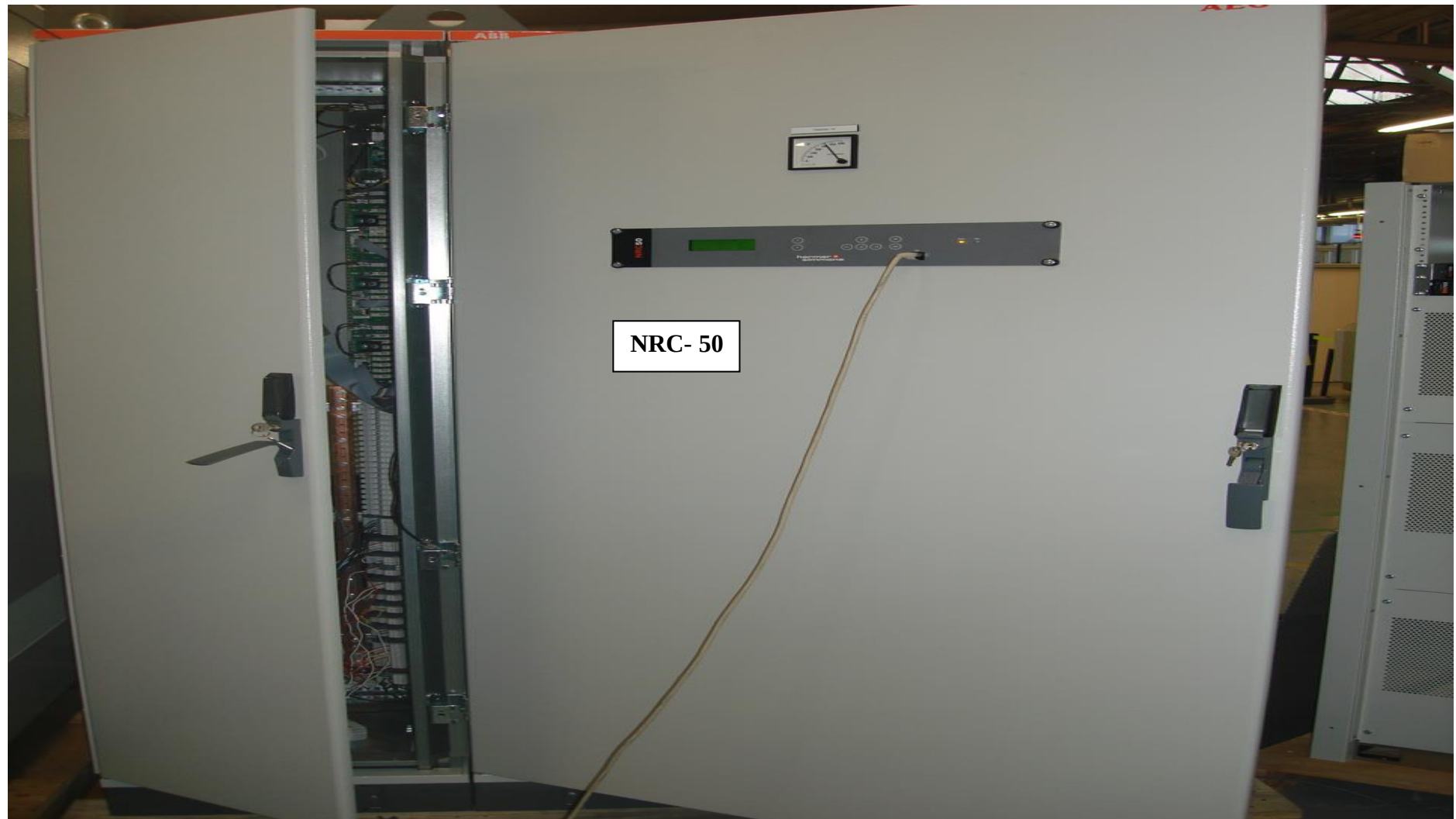
Photo 2 : Armoire de regroupement des branches.
