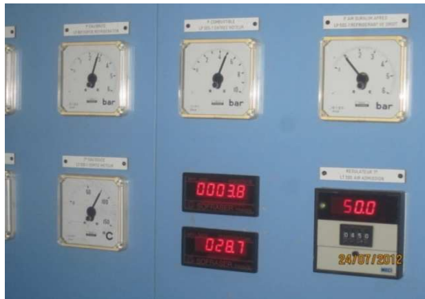
Les cellules de commande du PC4
