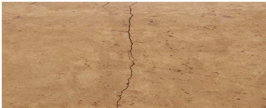
Photo 3 : Fissures traversant toute l'épaisseur de la couche (10/04/2013 à Yennega)
