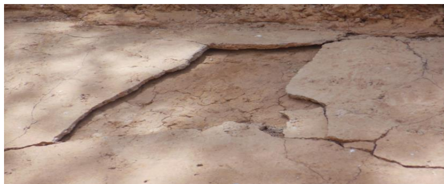
Photo 4 : Dégradation de la couche en béton (10/04/2013 à Yennega)
