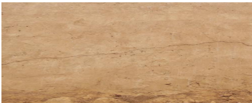
Photo 2 : Fissures superficielles (12/04/2013 à Sandouré)
