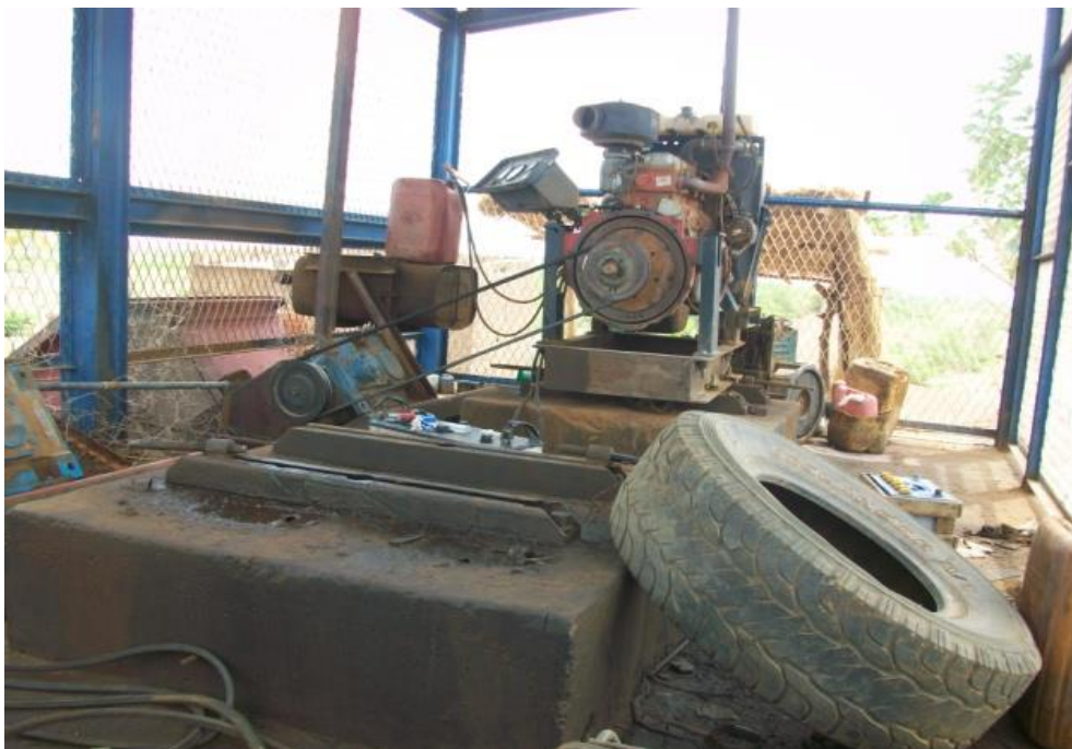
Photo 18: moteur diesel abandonné au niveau de la station de pompage au bloc C (Adjéffa, février 2013)
