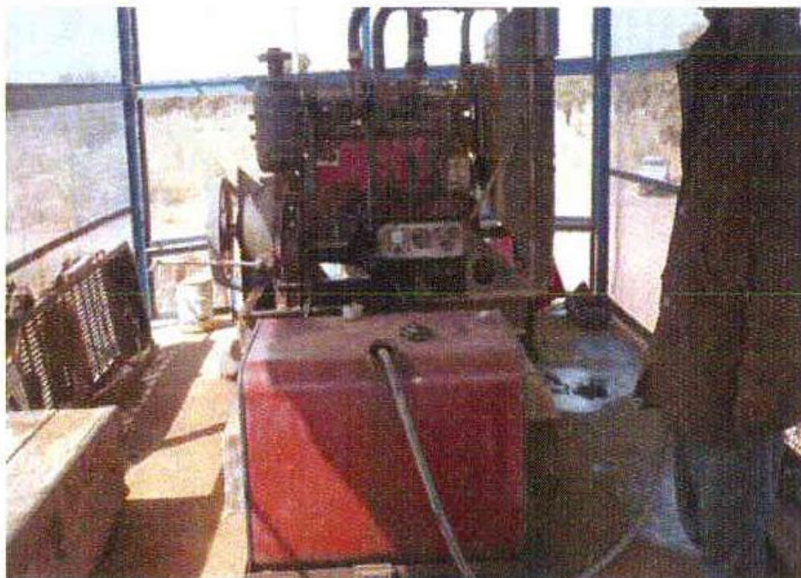
Photo 7: désordre dans le local (Adjeffa, 12/10/2013)
