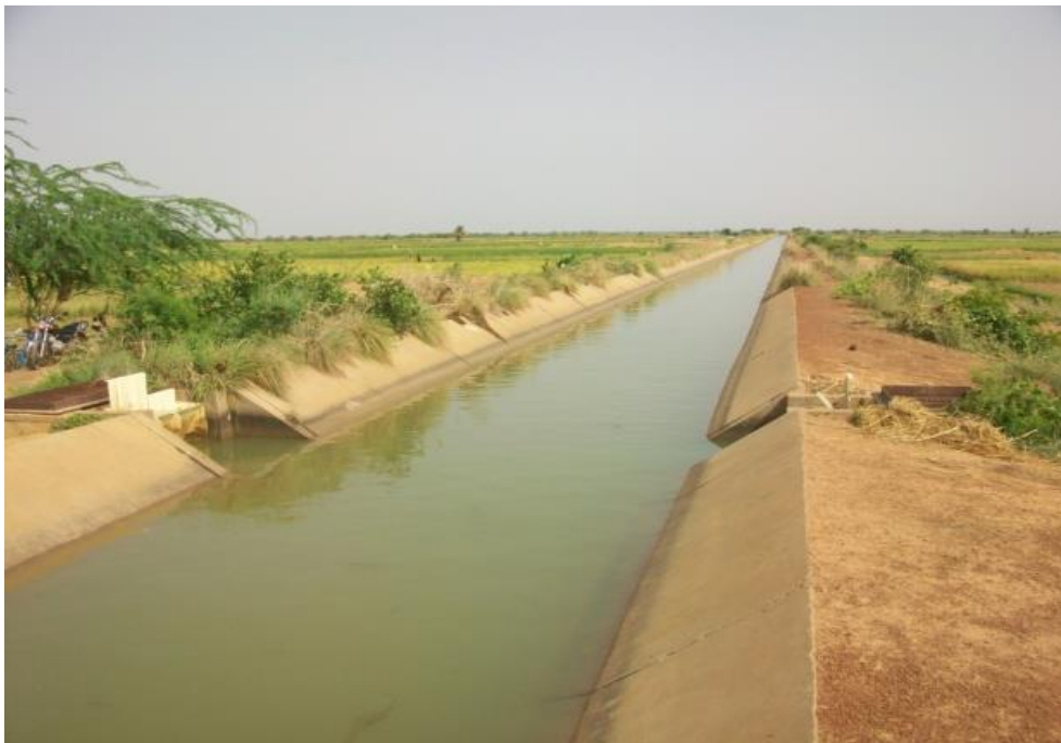
Photo 14: canal principal dotée de prises modulées (Adjeffa, 12/10/2013)
