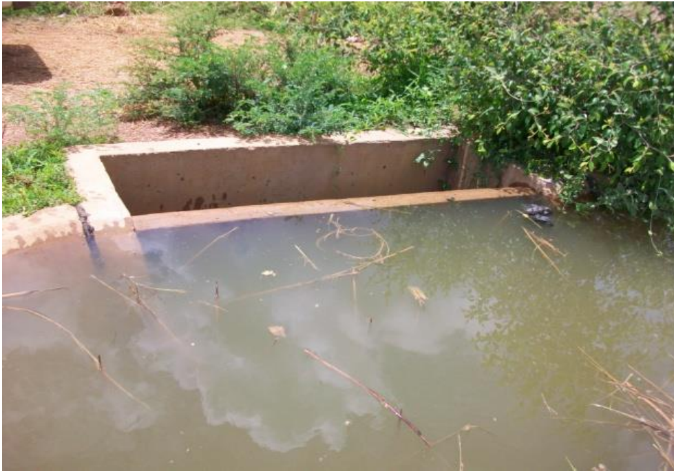
Photo 19: niveau d'eau élevé dans le canal secondaire (Adjeffa, 21/12/2012)
