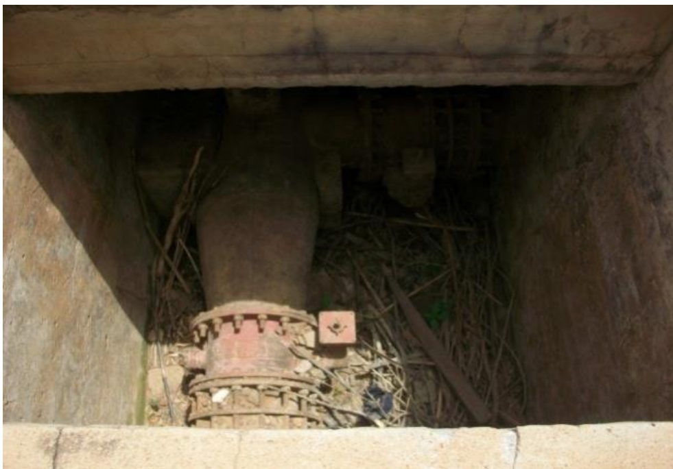
Photo 3: conduites en acier (Adjeffa 21/02/2012)
