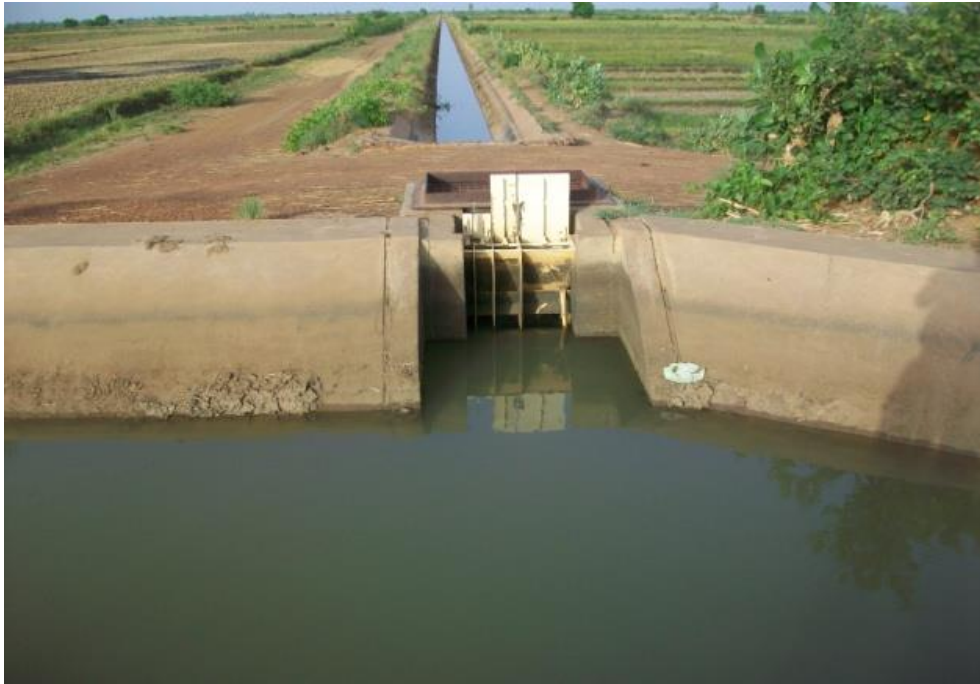
Photo 16 : prise modulée alimentant le canal 2 nd aire (Adjeffa, février 2013)
