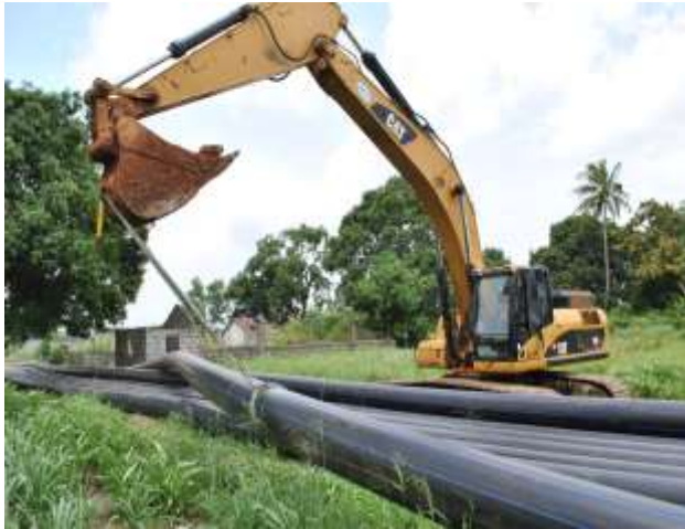
Photo 6 : Bardage des tuyaux
