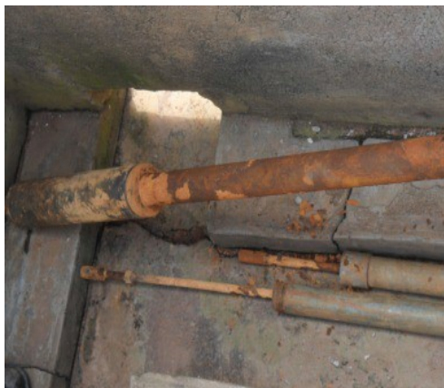
Figure10: Equipements vétustes de PMH
