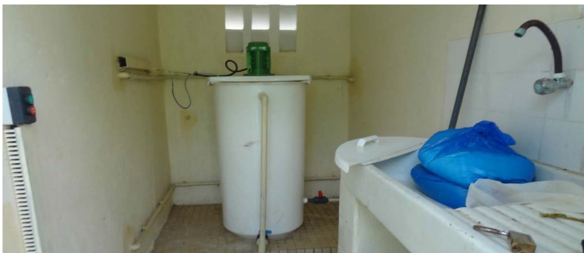
Figure 12: Bac de préparation de la chaux
