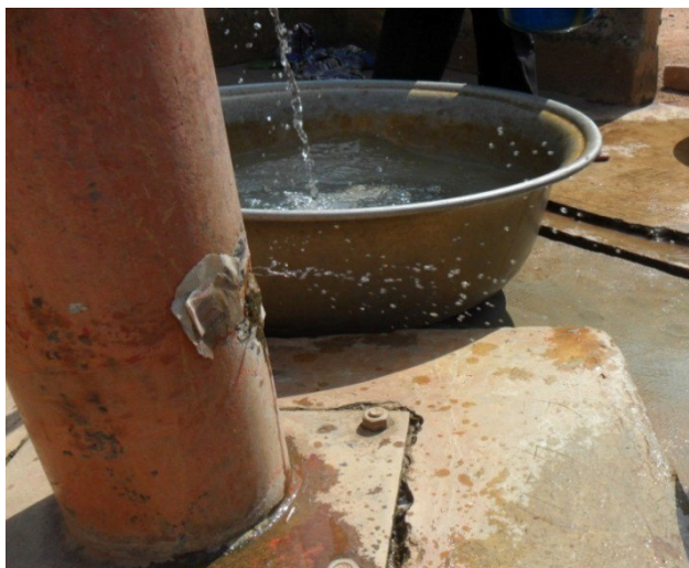
Figure 11: PMH avec une fuite
