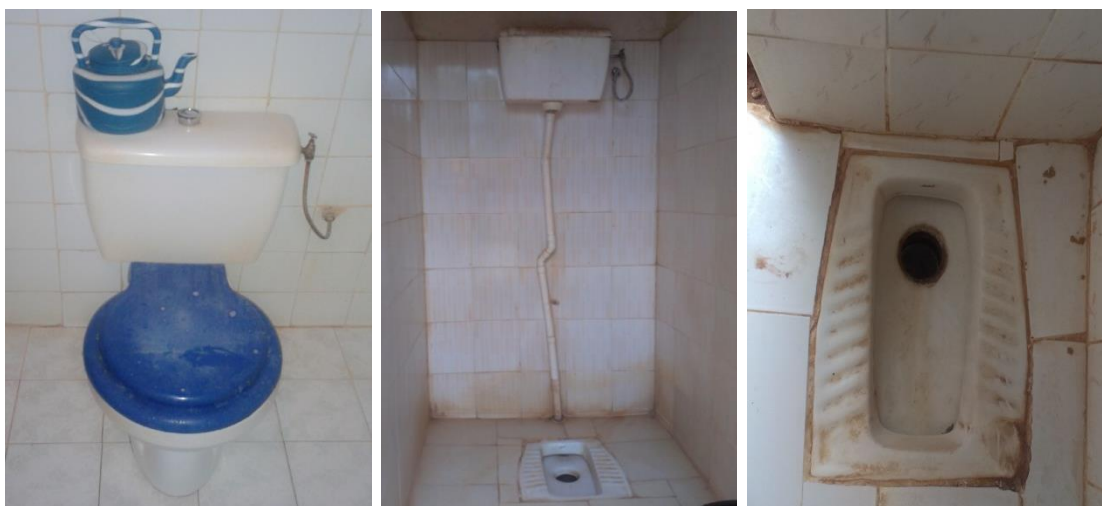
Photo 4 : Toilettes à chasse manuel
