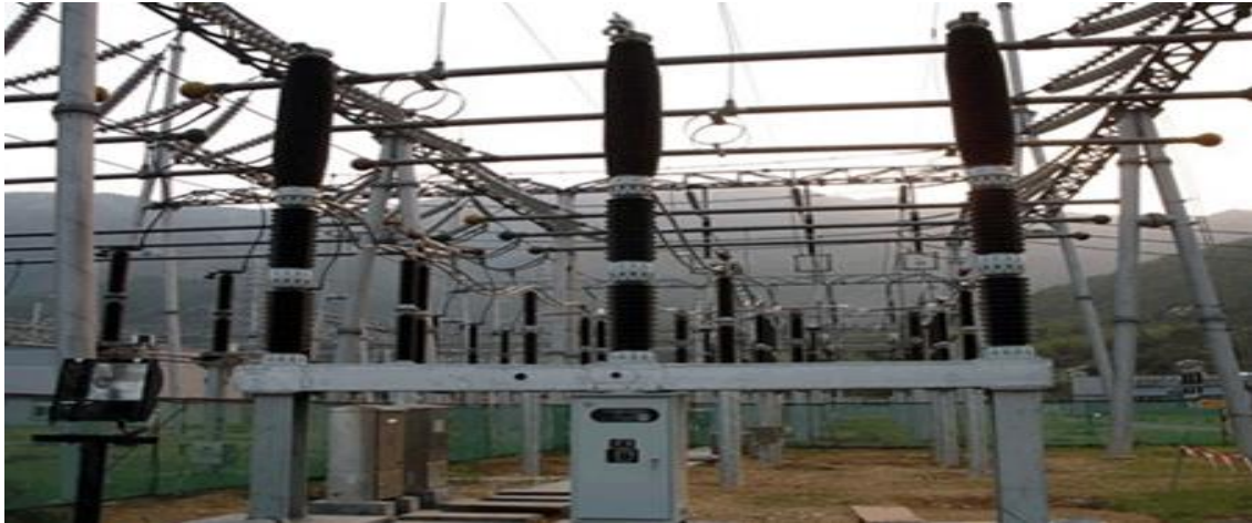
Figure 24 : Une vue du disjoncteur 52L
