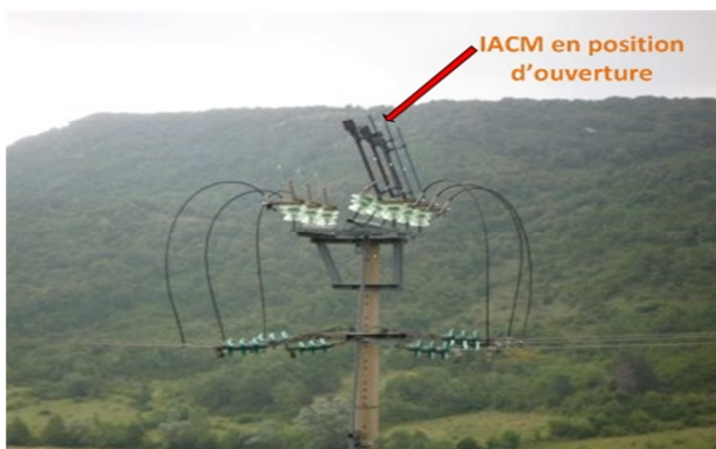
Figure 9- interrupteur aérien à commande manuelle
