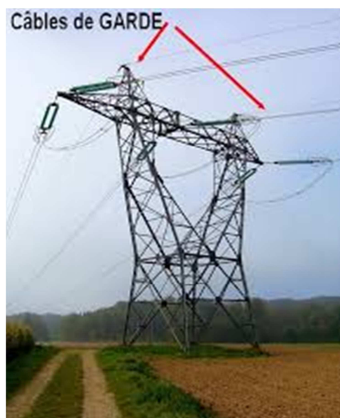
Figure 8- Pylône HTB avec câble de garde
