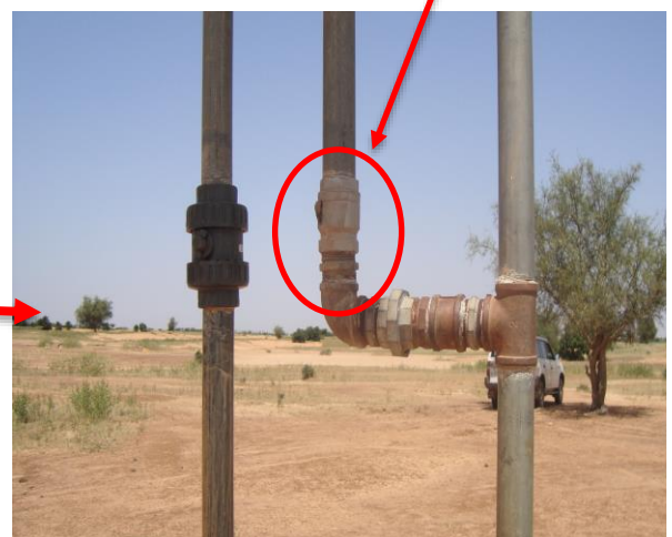
Figure 7 : Vue des vannes de distribution et de la vidange au niveau du château
