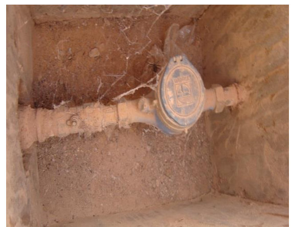
Figure 12 : Vue du Compteur d'un abreuvoir
