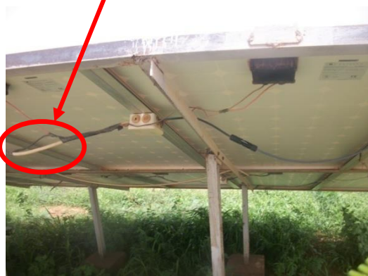
Figure 17 : Vue du câblage de connexion des PV
