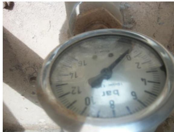
Figure 5 : Manomètre de la tête du forage
