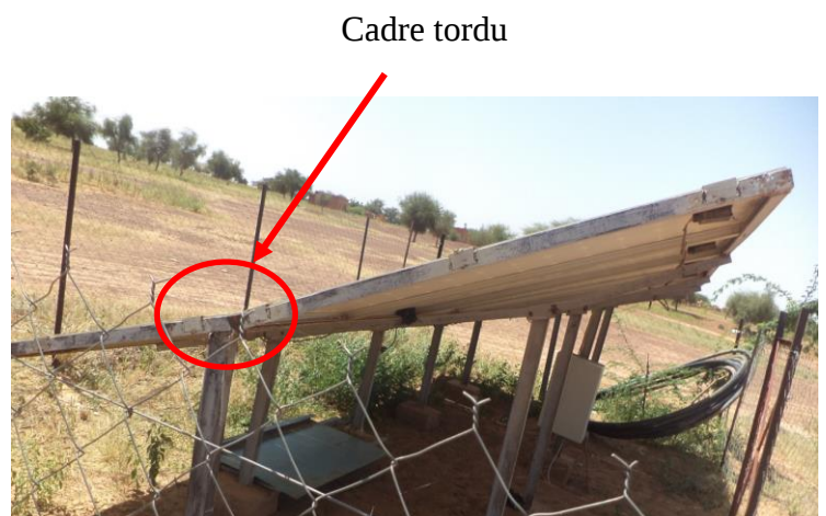
Figure 14 : Vue du cadre tordu du champ solaire
