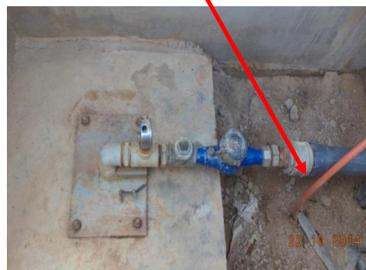
Figure 18 : Vue du câble d'alimentation du moteur de l'électropompe
