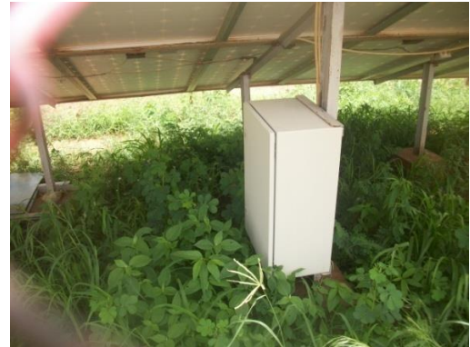
Figure 16 : Vue du Coffret de commande
