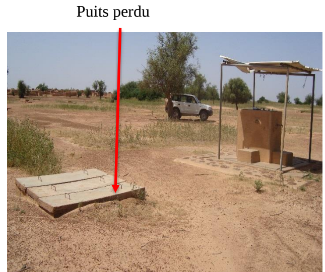
Figure 10 : Vue du puits perdu couvert de dalles non loin de la borne fontaine
