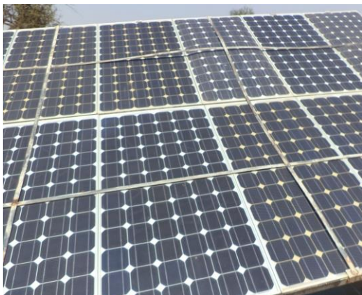
Figure 13 : Vue des panneaux solaires
