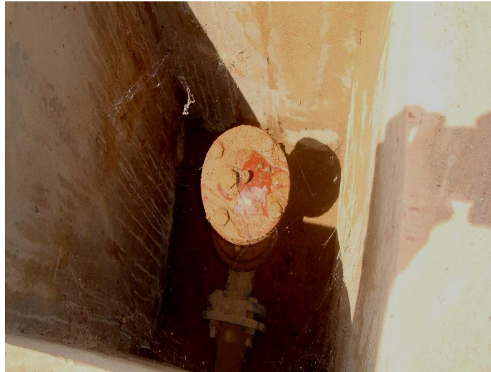
Figure 8 : Vue de la ventouse dans son regard au pied du réservoir
