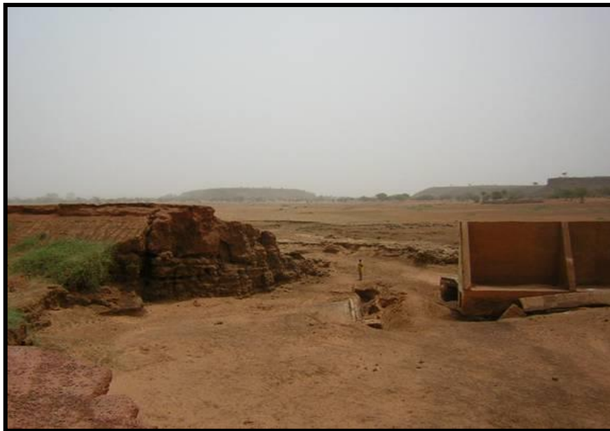
Figure I-2: Rupture de la digue du barrage de Bani au Burkina Faso. Photo : H. Karambiri.
