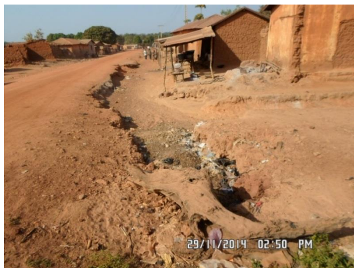
FIGURE 3: RAVINEMENT LATERAL SUR LA ROUTE
