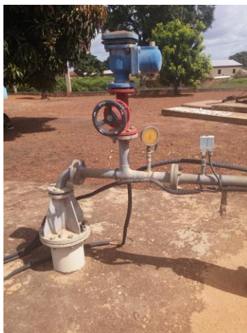
Photo VII : Vue des équipements de la tête du forage de Nangatchori
