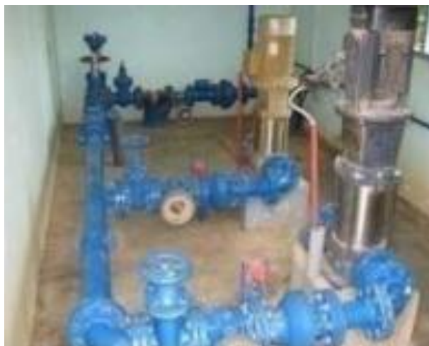
Photo VI: Vue de la salle de pompage
