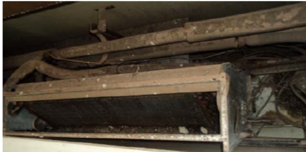
Figure 9 : Ventilo-convecteur en état délabré
