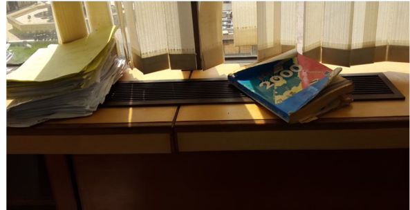
Figure 10 : Mauvaise utilisation des ventilo-convecteurs
