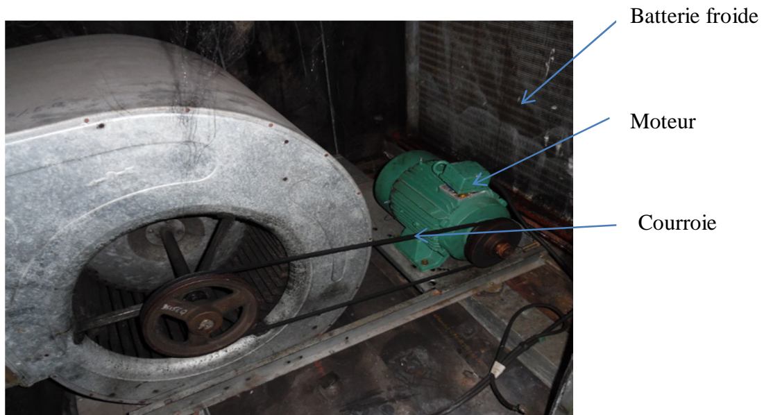
Photo 2 : Eléments de la Centrale de Traitement d'Air
