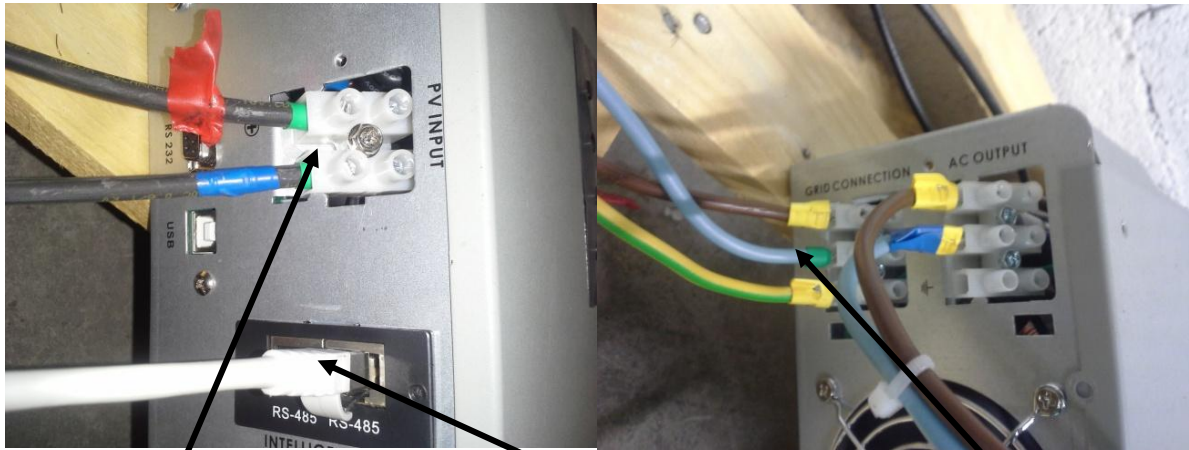
Arrivée du champ PV Liaison RS 485 entre l'onduleur et l'automate Arrivée du réseau
