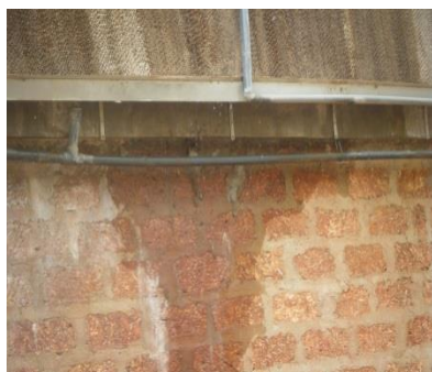
Figure 21:Fuite sur les pad cooling
