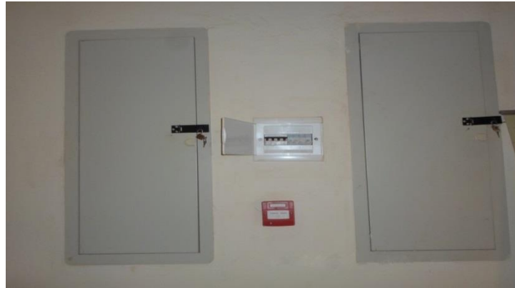
Figure 4: Deux Tableaux électriques et un coffret parafoudre par niveau
