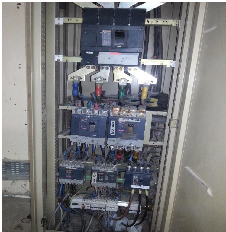
Figure 1 : Vue de l'armoire principale
