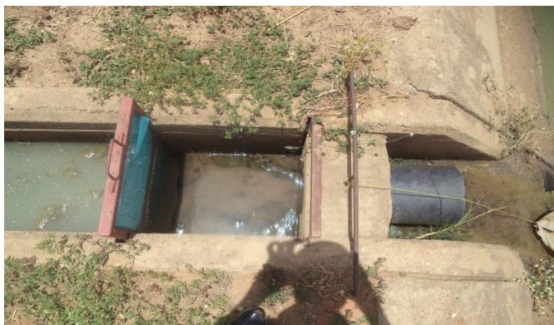
Figure 7: Vue d'un canal d'admission avec ses équipements de fonctionnement
