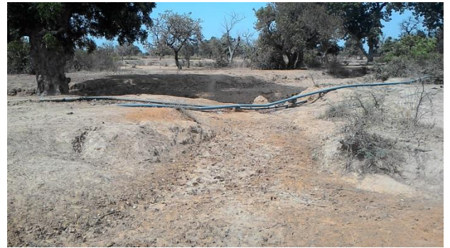
Aperçu de la longueur des PVC utilisé, pouvant atteindre des centaines de mètres
