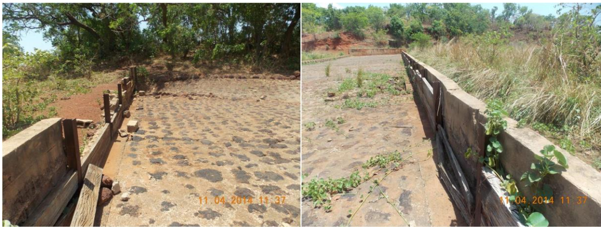
Photos 5: batardeau et muret inexistant à l'extrême au centre et basting détériorés et muret fissuré et déformé
