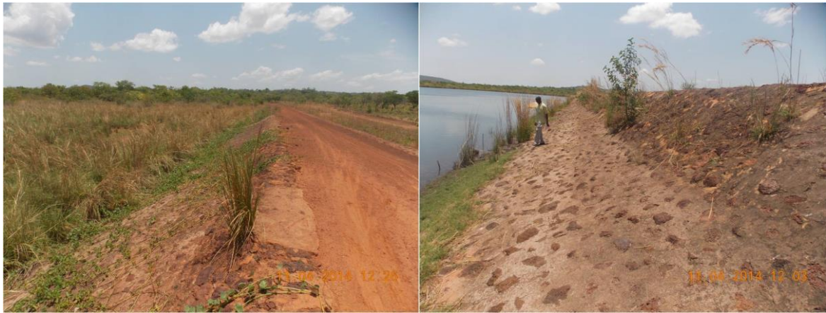
Photos 1 et 2 : Présence d'herbes au pied du talus et Présence d'arbustes et d'herbes sur le talus amont
