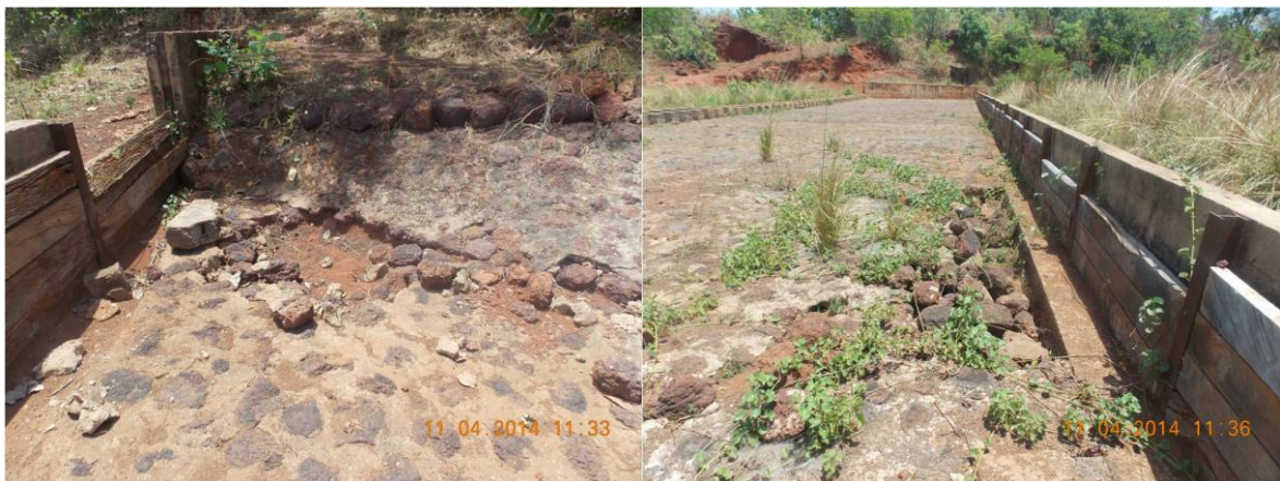
Photos 6 : perré maçonné inexistant à l'extrême rive gauche et perré maçonné dégradé au pied du batardeau
