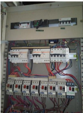
Figure 6 : Tableau électrique Piste
