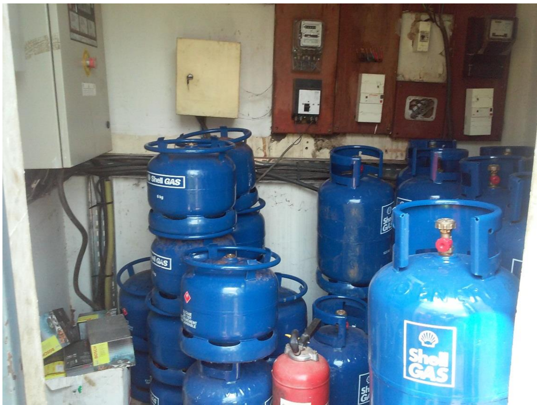
Figure 4 : Intérieur du local compteurs.
