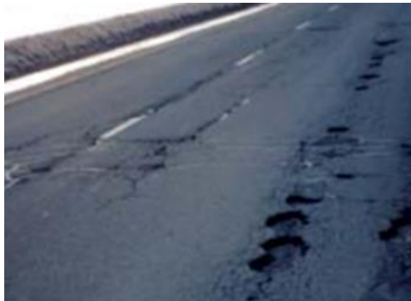
5-desenrobages et arrachements de revêtement
