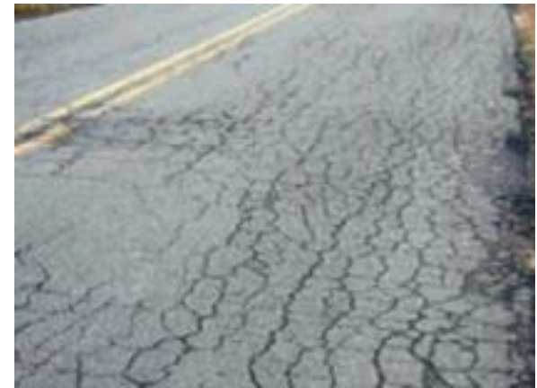
3-fissures en carrelage
