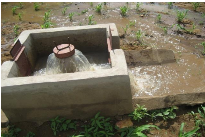
Figure 4: Ouvrage à une prise équipée de vannettes et d'une rehausse d'où sort l'eau
