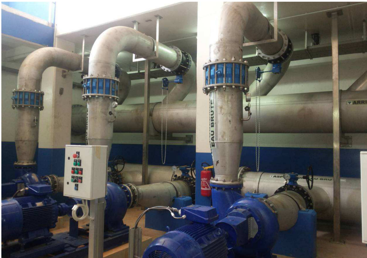
Annexe 2 : station de pompage d'eau brute
