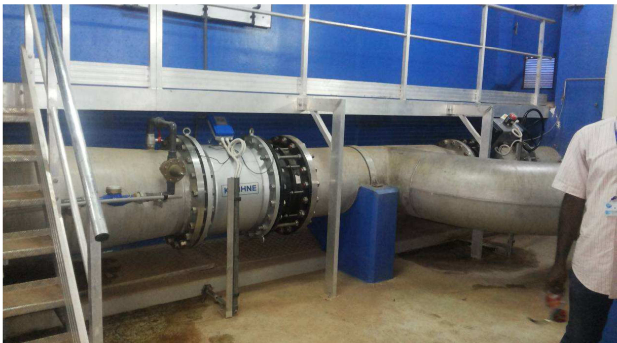
Annexe 6 : Débitmètre d'eau traitée
