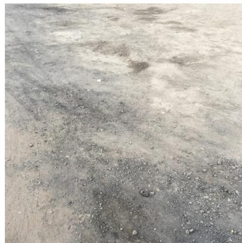
Figure 4: États dégradés de la rue B2 et E2
