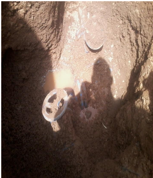
Fuites sur vanne
