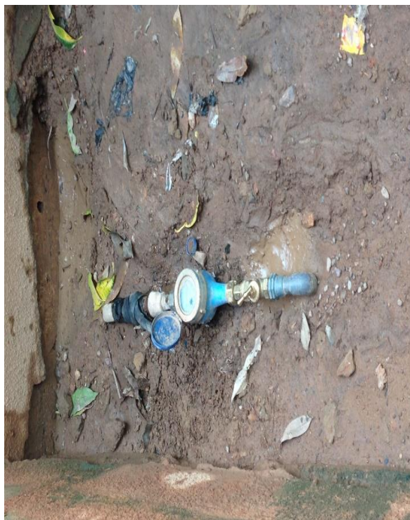
Fuite au compteur(robinet d'arrêt amont)
