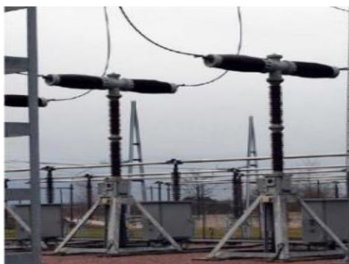
Figure 14: Disjoncteur au SF 6
