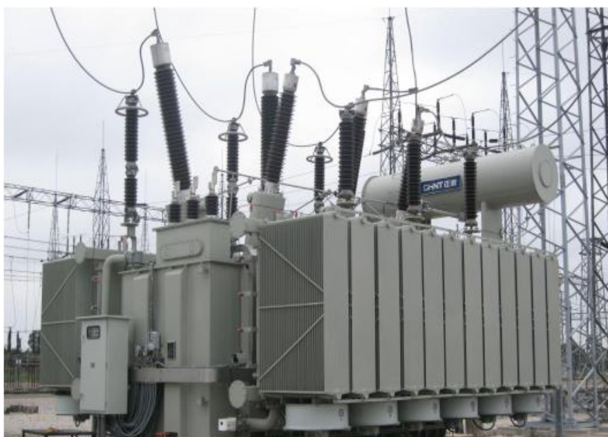
Figure 15: Transformateurs de puissance/ Transformateur de répartition
