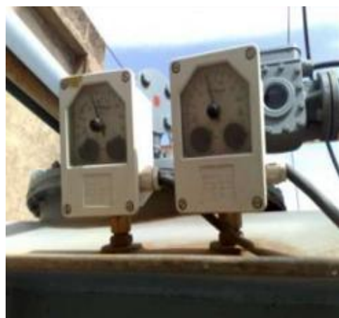
Figure 21: Dispositif de détection de température
