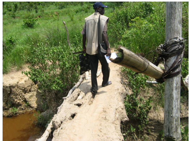
Photo7 : Etat d'un ouvrage de franchissent
