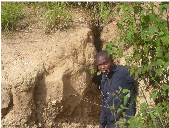
Photo 6: Canal d'évacuation de crue très érodé
