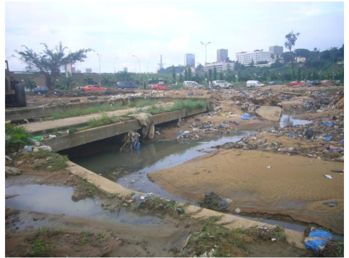
Photo 2 : Carrefour de l'Indenié : Dalots sur C 1 en amont des échangeurs
