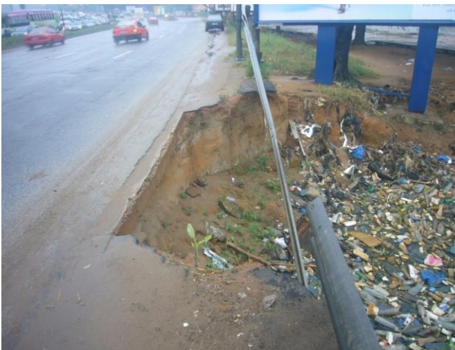
Photo 3 : Importante érosion de la voirie au carrefour de l'Indenié
