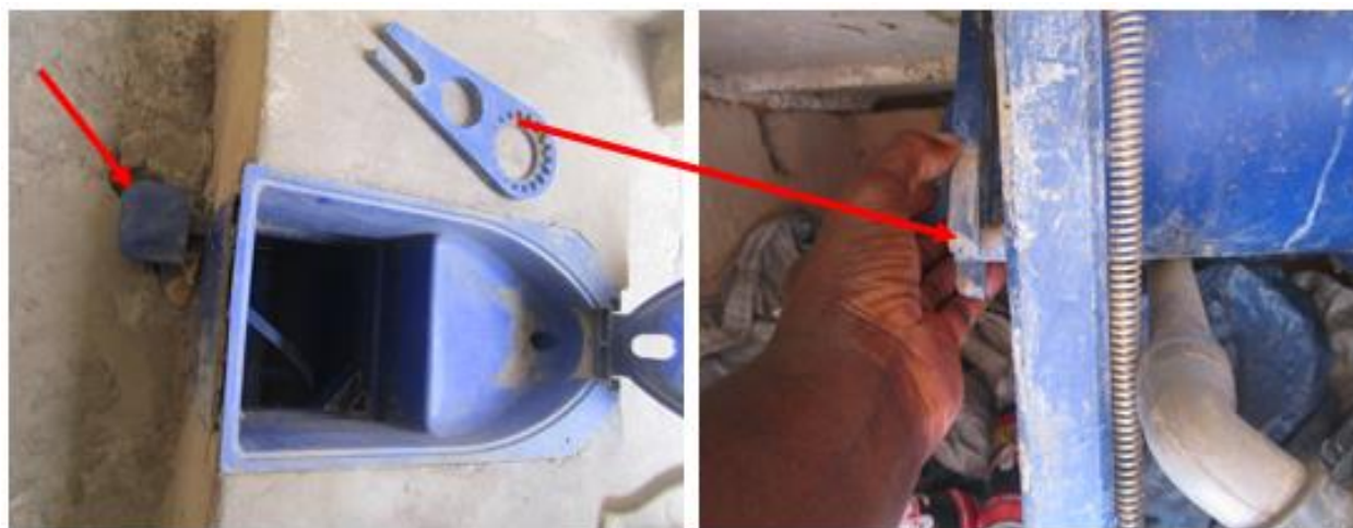
Figure 12: Image montrant la pédale défectueuse d'une toilette Earth Auger
