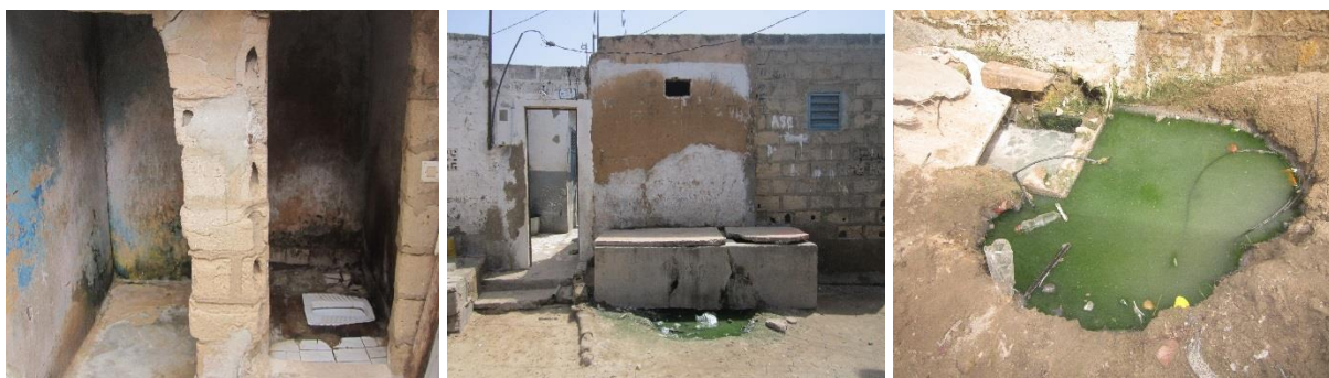
Figure 3: Images sur la situation dégradante des ouvrages sanitaires dans la zone (Photos A. SARR)
