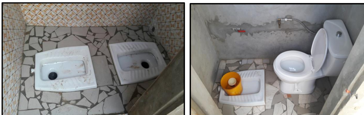
Figure 16: Disposition des deux chaises dans une toilette Biofilter
