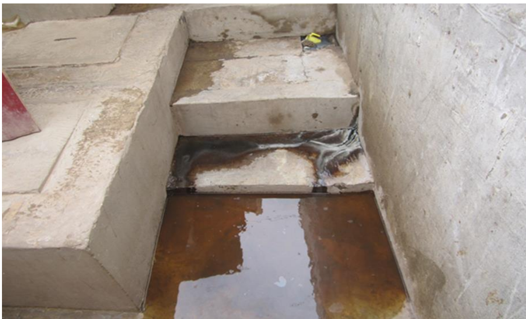
Figure 17: Images sur quelques problèmes rencontrés sur la toilette à filtre bactérien (Biofilter)
