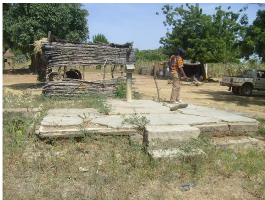
Figure 7 : Forage avec margelle et trottoir anti-bourbier dégradés dans le village de Konli1 de la commune de Tambaga
