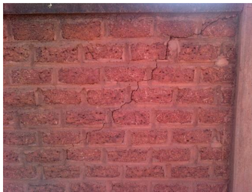
Figure 3 : Pathologie de la maçonnerie, Fissuration dues au cisaillement
