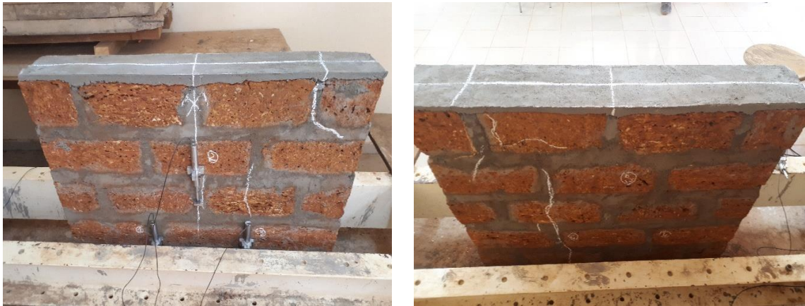
Photo 12: Fissuration du Muret en BLT sous chargement vertical
