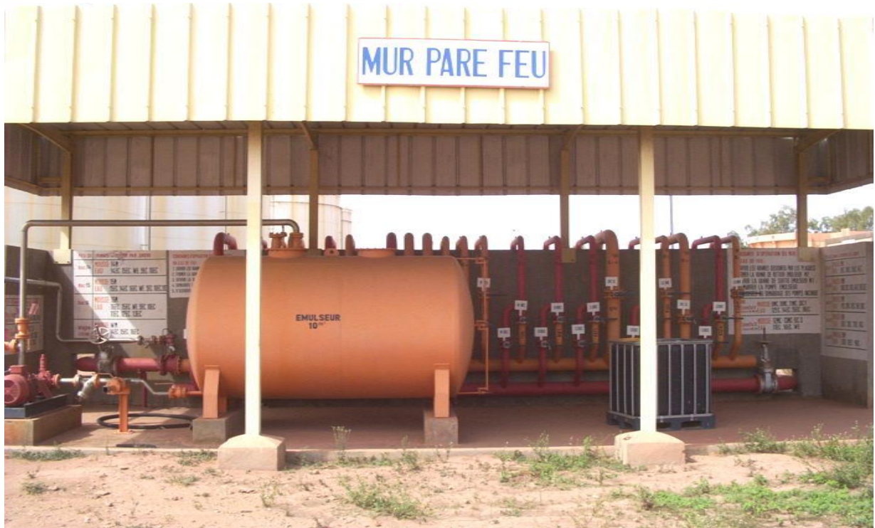
Mure pare feu : permettant d'être protégé des flammes pour manœuvrer l'ouverture ou la fermeture des vannes d'eau et d'émulseurs
