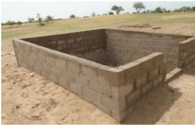
Figure 8 : Fosse à ordures
