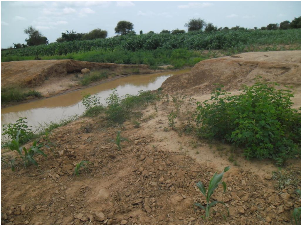
Figure 5: Digue de protection endommagée
