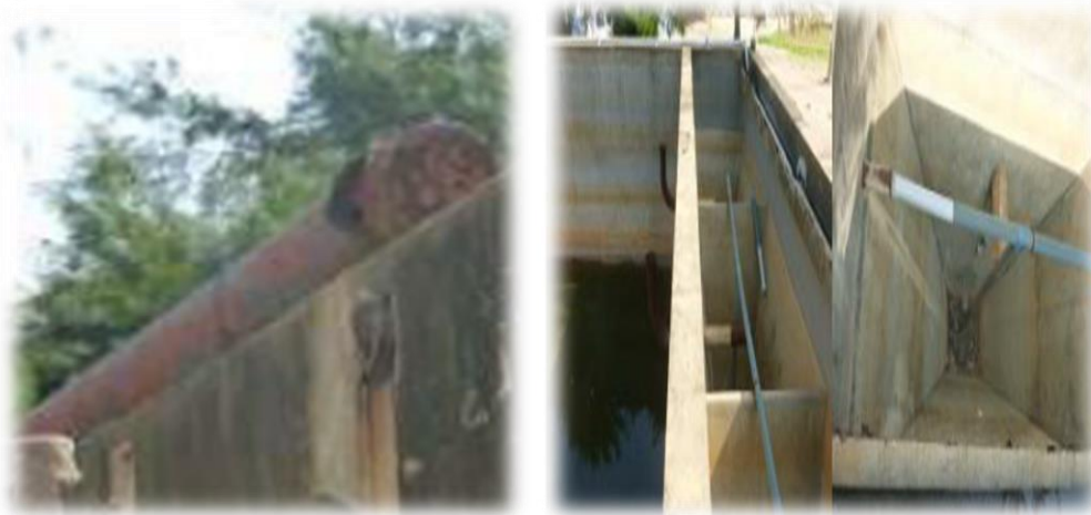
Figure 10 : La conduite d'aération corrodée et les trémies de décantation des boues (Dadjo, avril 2017)
