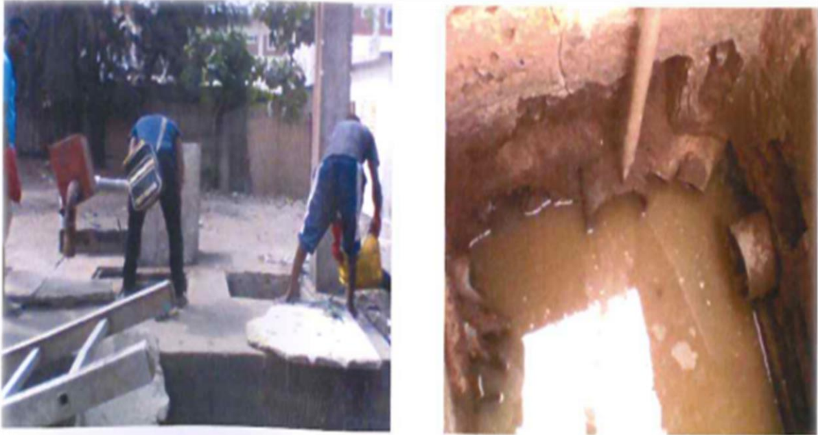
Figure 4 : Dalle et Regard endommagés (Dadjo, avril 2017)
