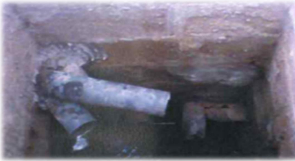
Figure 5: Canalisation dans les regards (Dadjo, avril 2017)
