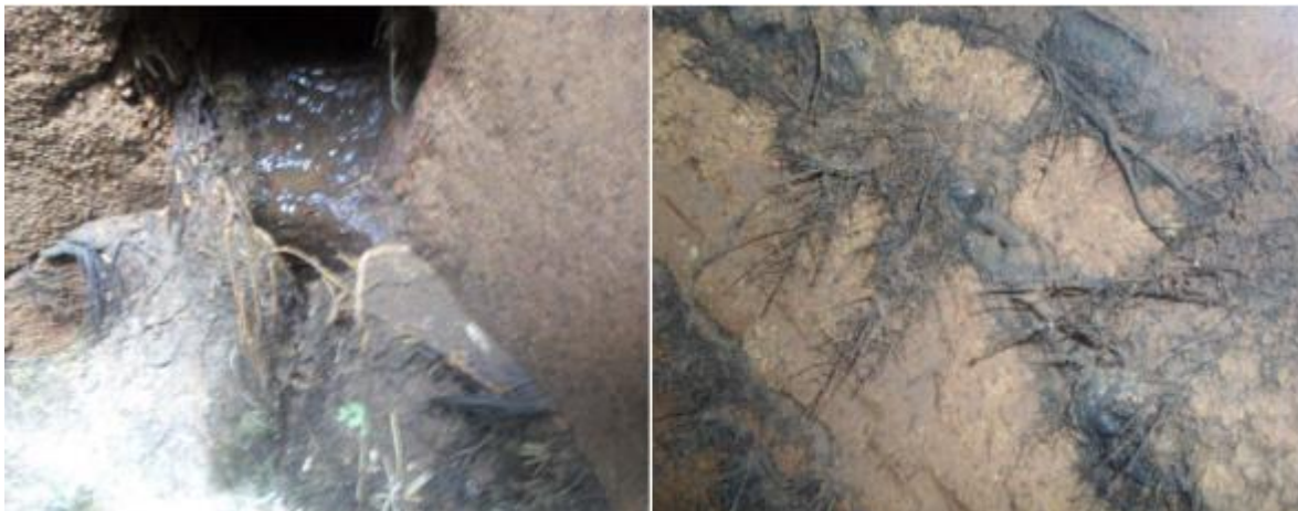
Figure 3 : Racines de plantes bouchant les conduites, (Dadjo, avril 2017)
